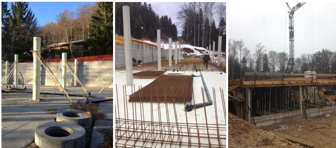
Construction des piliers de soutien et des dalles [novembre 2012 – avril 2013] (photos François L. Althaus)
