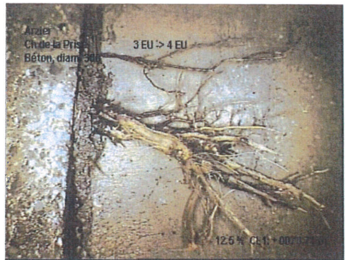
Photo: 26_6b, 00:06:54 73.7m, Raccord ouvert de 03 à 09 h., mal jointoyé, racines
