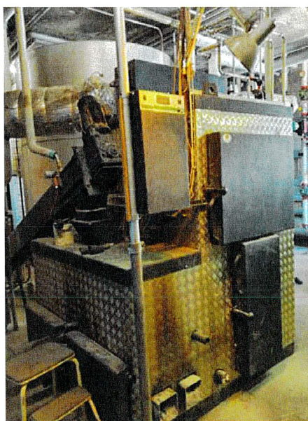
Figure 1 : Chaudière à bois installée en 2008, hors service depuis 2020
