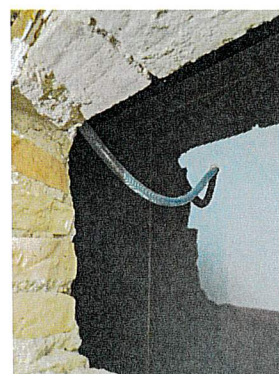
Figure 3 - Evacuation chambre froide
