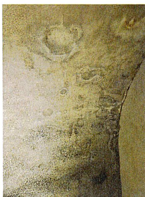
Figure 2 - Etat du mur du Carnotzet
